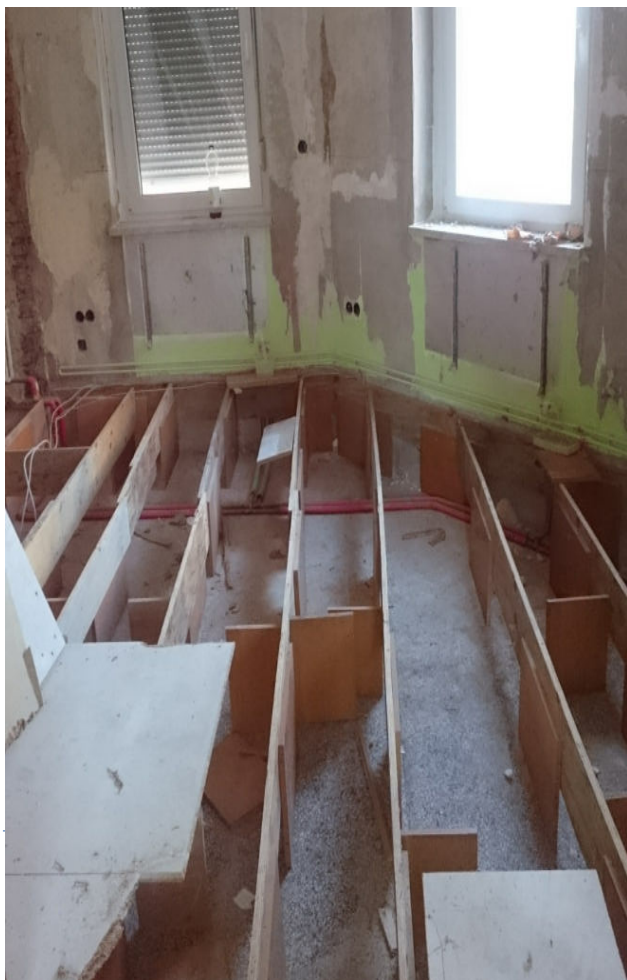
...und plötzlich geht's nach unten! Unerwartete Bodenunterkonstruktion in der Lindenstraße
